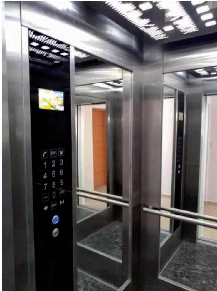
Ascensor instalado en el “Edificio Paihuén” en Santa Rosa.
