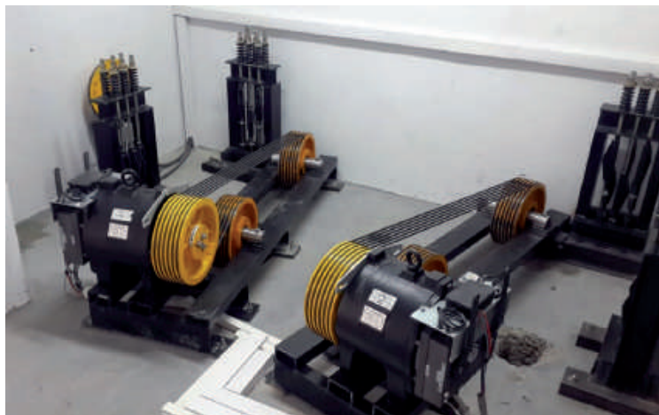
La Empresa ha instalado ascensores en la ciudad de Neuquén de 150 mpm con máquina Gearless (foto) y 25 paradas.
