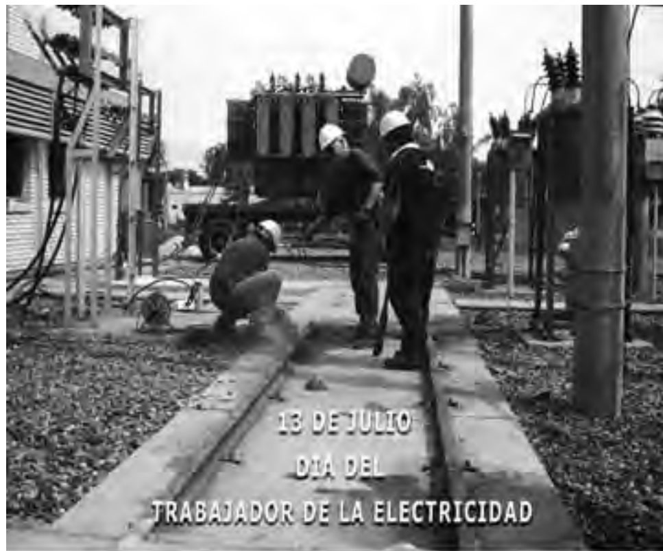
13 DE JULIO DÍA DEL TRABAJADOR DE LA ELECTRICIDAD Administración Provincial de Energía MINISTERIO DE OBRAS Y SERVICIOS PÚBLICOS GOBIERNO DE LA PAMPA
