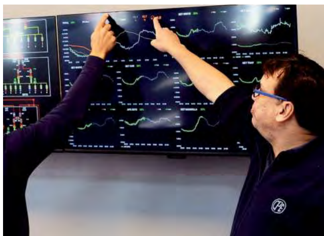
Pablo Stellin y Rodolfo Sosa, uno de los técnicos que modificaron e instalaron el sistema SCADA, muestran los parámetros que constantemente se cotejan para operar la red y sus componentes.
