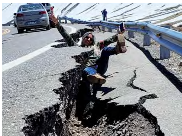
Stella López, corresponsal de Grupo América en Malargüe, se metió en una de las grietas de la ruta 145 camino al paso Pehuenche, provocada por las tormentas ocurridas en junio 2023. (foto del día 16/01/24).
